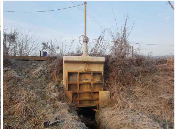
랙크바 상태 양호
